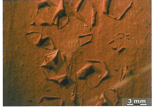
Abb. 20 Funori: Bei zu hohen Konzentrationen von Funori (1 Anstrich, 2%) führte die Bewitterung zu massivem Aufrollen des Bindemittels.
