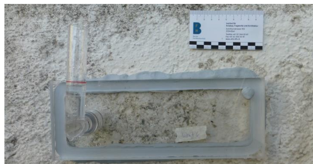
Abbildung 15: Messung W6 an der deutlich verschmutzten Westfassade.
