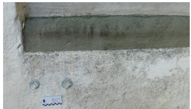
Abbildung 11: Messungen im verschmutzten Bereich unter der Brüstung der Nordfassade.
