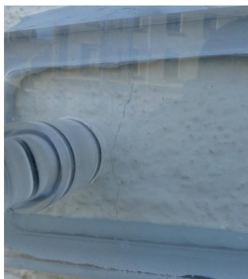
Abbildung 17: Die Nahaufnahme zeigt den von oben nach unten verlaufenden Riss.
