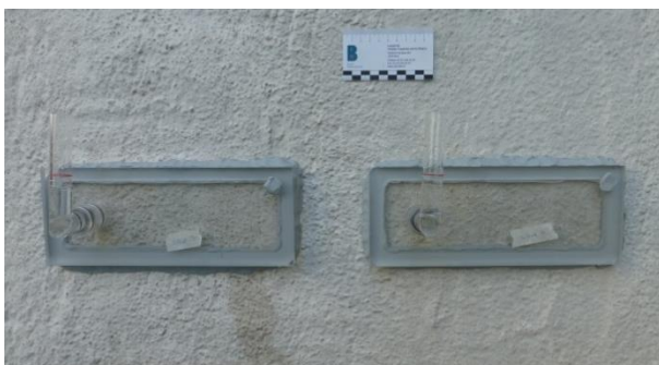
Abbildung 14: Mangelhafte Messung an der Westfassade.
