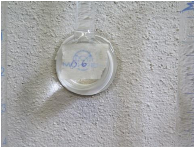
Abbildung 21: An der Testfassade ohne Farbanstrich ist ein deutlicher Feuchtigkeitsring um die Glocke des Karsten'sche Randeffekt bei der Franke'sche Prüfplatte nicht sichtbar, Prüfröhrchens auszumachen.
