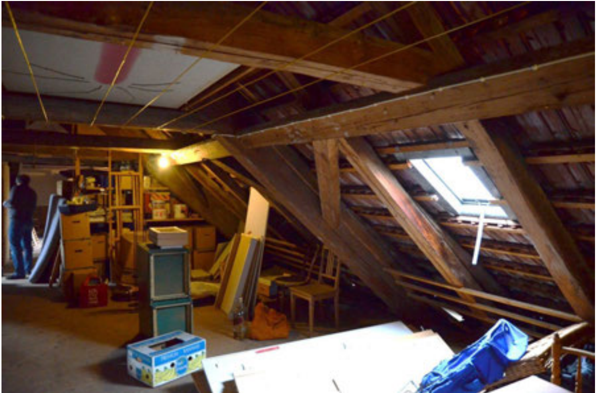
Abbildung 75 , Nicht ausgebauter, bauzeitlich doppelt liegender Dachstuhl, Sparrendach mit verkanteter Firstpfette und Mittelpfette, mit Bügen versteifte und verzapfte Konstruktion, wenige nachträglich eingebaute Dachflächenfenster. (Foto H. Dobler, Jan.2015)
