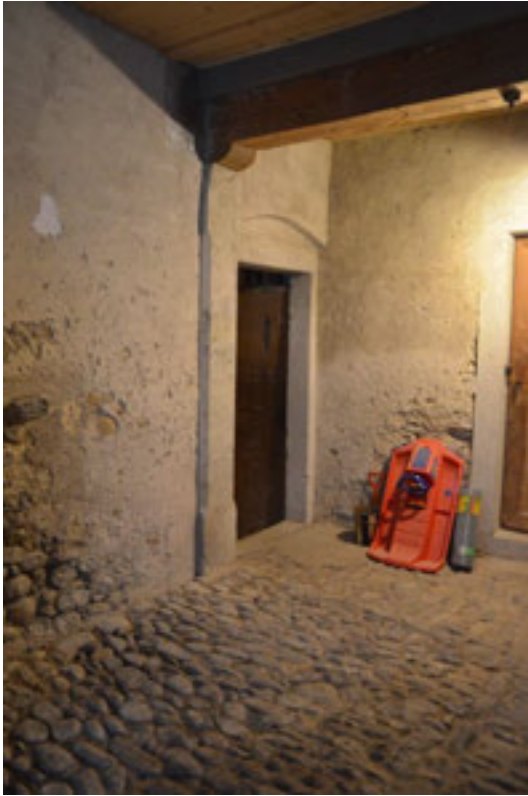
Abbildung 77 , Zugang zu den mit Holzverschlügen abgetrennten Kellerräumen, aus der Bruchsteinwand leicht vorstehender Stützpfiler, Flusswackepflasterung.
