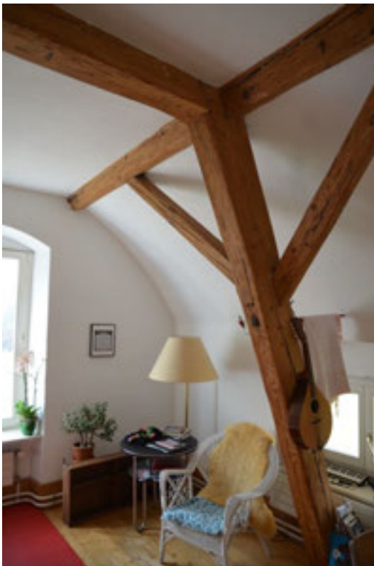
Abbildung 113 , Dachwohnung mit sichtbarer Dachstuhlkonstruktion, ein Bug in Querrichtung wurde herausgetrennt. (Foto H. Dobler, März 2015)
