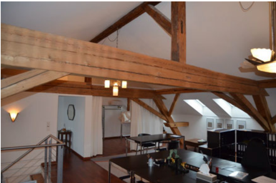
Abbildung 154 , ausgebauter Dachstock im Kosthaus Nr.2, original erhaltener liegender Dachstuhl mit strebengestützter Firstpfette, einzelne Kopfhölzer (z.B. Zapfenloch am Firstpfosten) fehlen. (Foto H. Dobler Oktober 2015)
