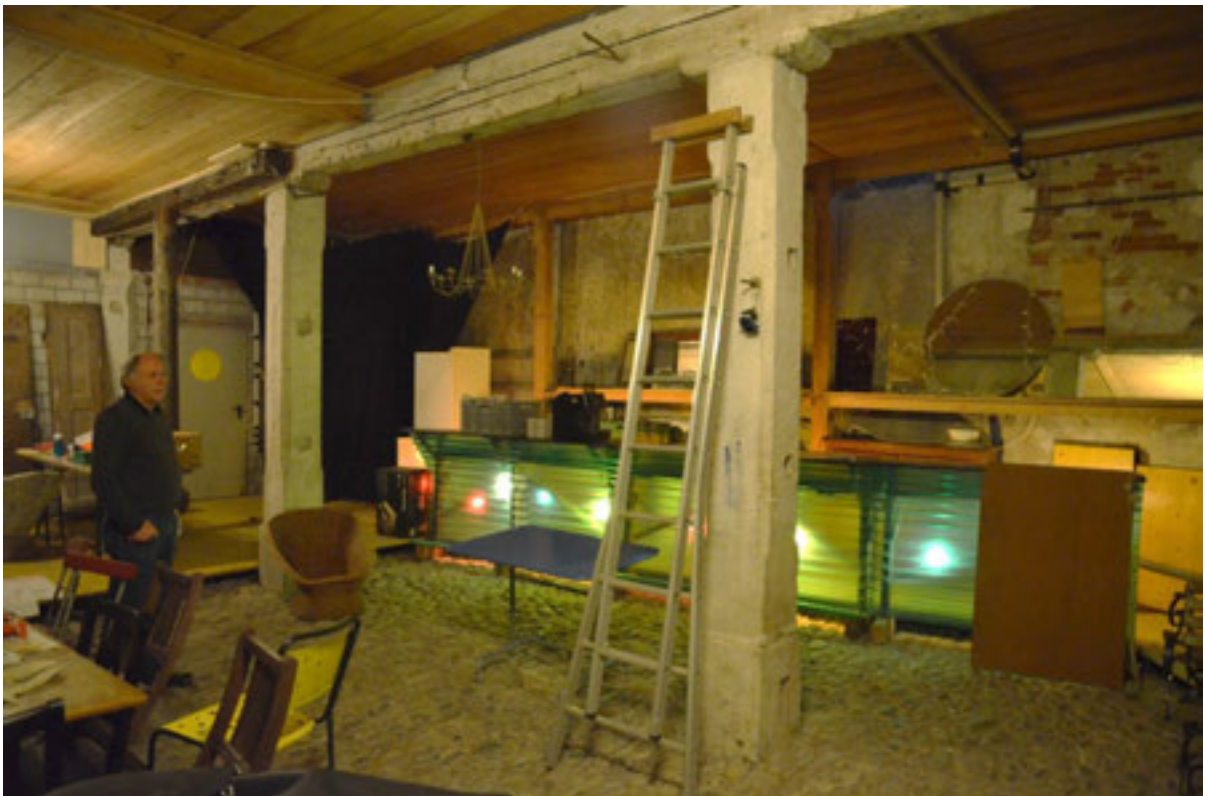
Abbildung 76 , Teil des Kellers unter der östlichen Haushälfte. Gefaste Stützpfeiler aus Muschelkalkstein tragen über ein Sattelholz die Deckenbalken. Der Raum diente ursprünglich vielleicht als zusätzliche Produktionsstätte. Beachtlich die durchgehende Flusswackenpflasterung. (Foto H. Dobler, Jan.2015)
