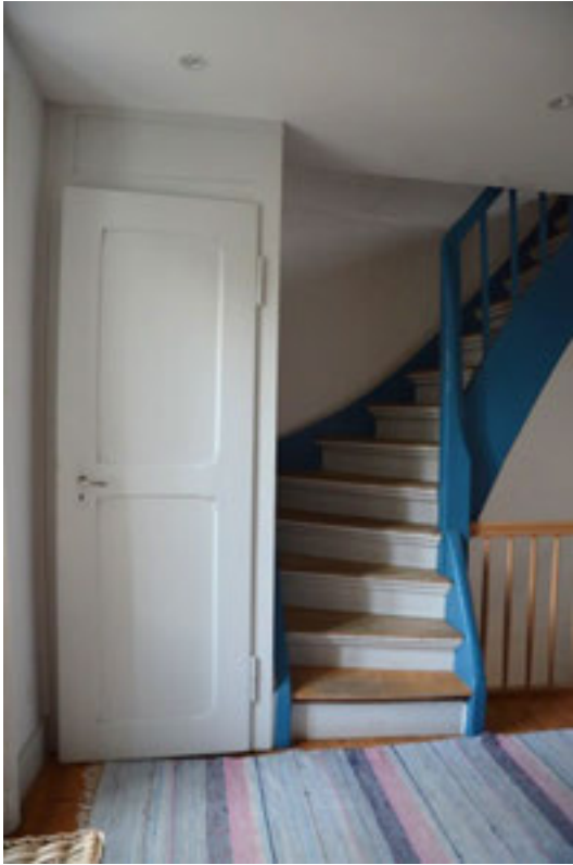
Abbildung 71 , originaler Treppenaufgang im 1. Obergeschoss mit Türe zum Abort. (Foto H. Dobler, Jan. 2015)
