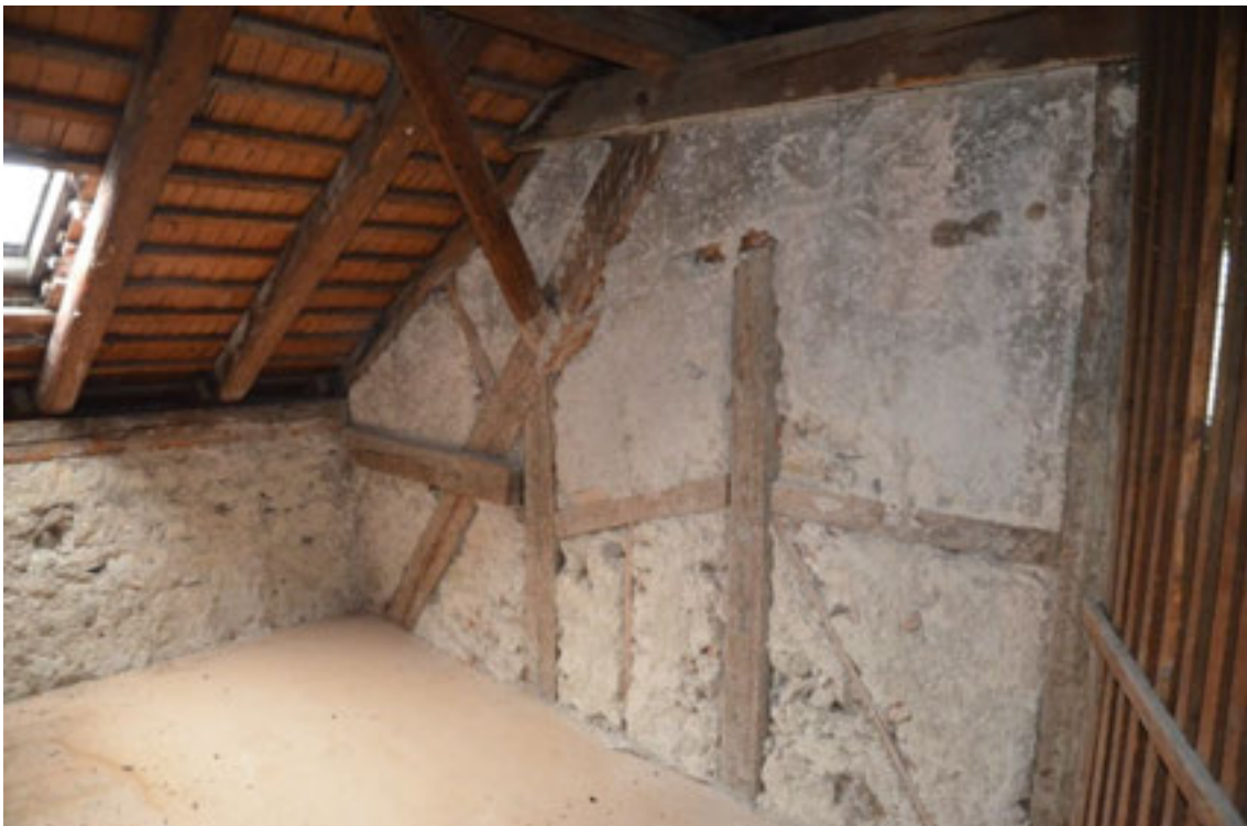
Abbildung 34 , Dachgeschoss mit ausgefachter Ständerwand zur abgetrennten Kammer, bauzeitliches Gebälk, Unterdach neu. (Foto H. Dobler Okt 2013)
