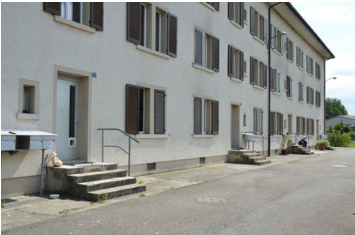
Abbildung 179 , Westfassade des Kosthauses mit den über Treppenpodeste erschlossenen vier Zugängen. Die Fassade ist mit einer Wärmedämmung verkleidet, die Fenstergewände sind nur aufgemalt, Türen, Fensterläden und Fenster gestalterisch und materiell fragwürdig erneuert. (Foto H. Dobler, August 2015)
