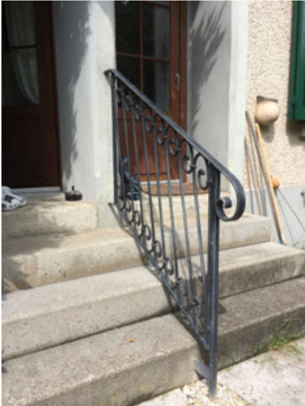
Abbildung 53 , Zugangstreppe mit originalem Geländer des früheren Hauptzugangs. Die oberste Schwelle bauzeitlich aus Mägenwiler Muschelkalk, die unteren Stufen durch Betontritte ersetzt (Foto H. Dobler August 2014).
