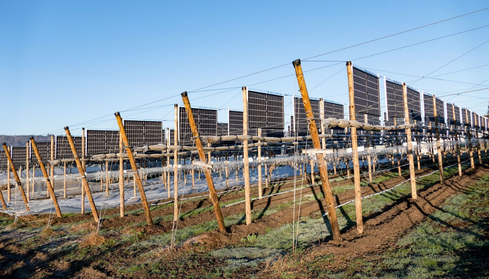
PV-Module lassen sich relativ einfach in senkrechter Position zwischen den vorhandenen Pfosten im Himbeerefeld montieren. (Foto: Bioschmid / D. Eppenberger)
