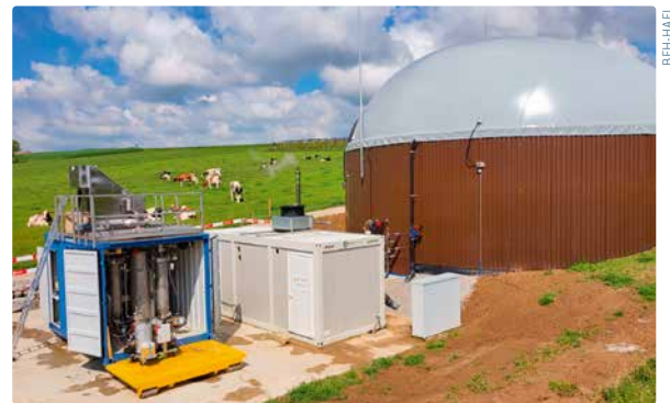
Cette installation produit deux fois plus de gaz.
